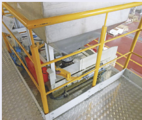
Der Absackbereich der Linie besteht aus sechs vollautomatischen Abfüllmaschinen für Ventilsäcke
